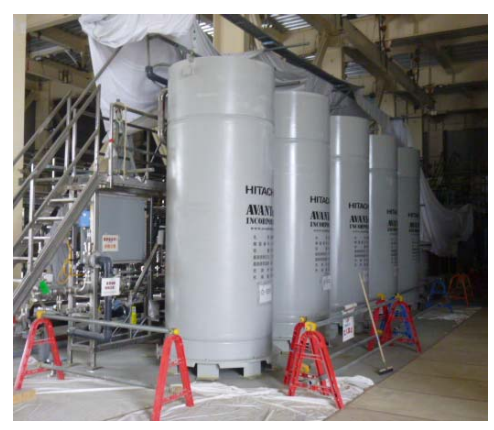
浄化設備（吸着塔）
