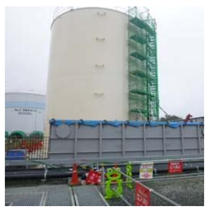
一時貯留タンク
