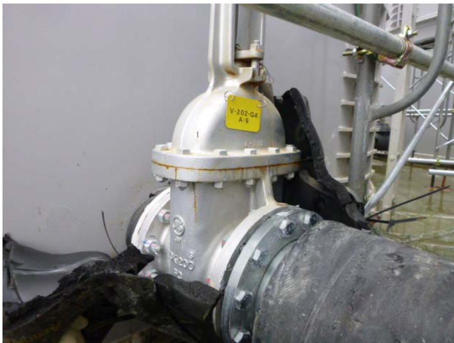
漏えいした弁（閉状態）
