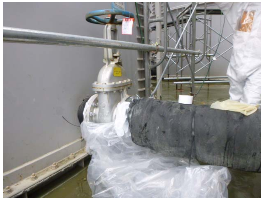
漏えい後の養生状況
