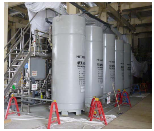
浄化設備（吸着塔）
