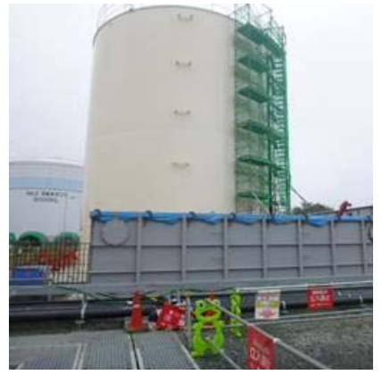
一時貯留タンク
