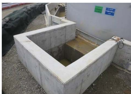
ポンプピット
