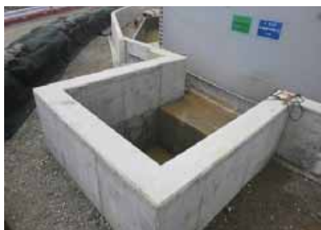
ポンプピット
