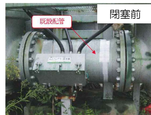
O.P.+4.0mの配管 (RHR S) 閉塞状況
