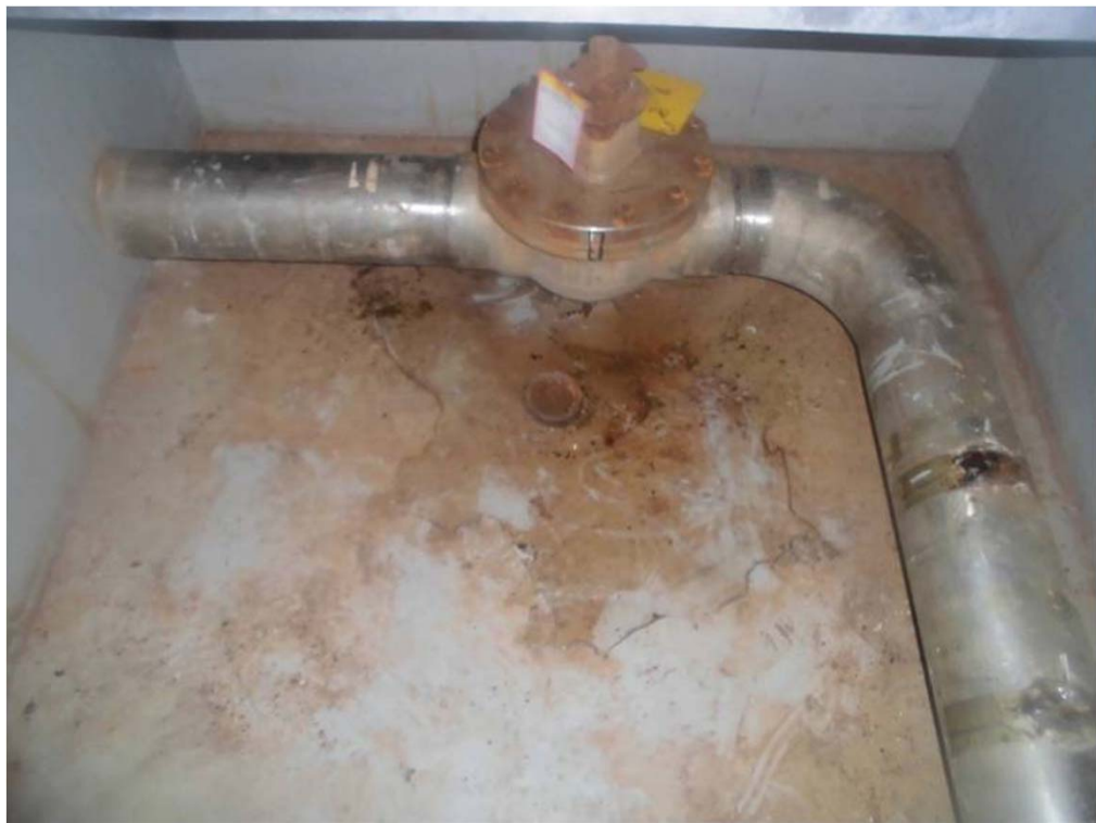
使用済燃料プール冷却浄化系 当該弁 ( F042B)漏えい状況
