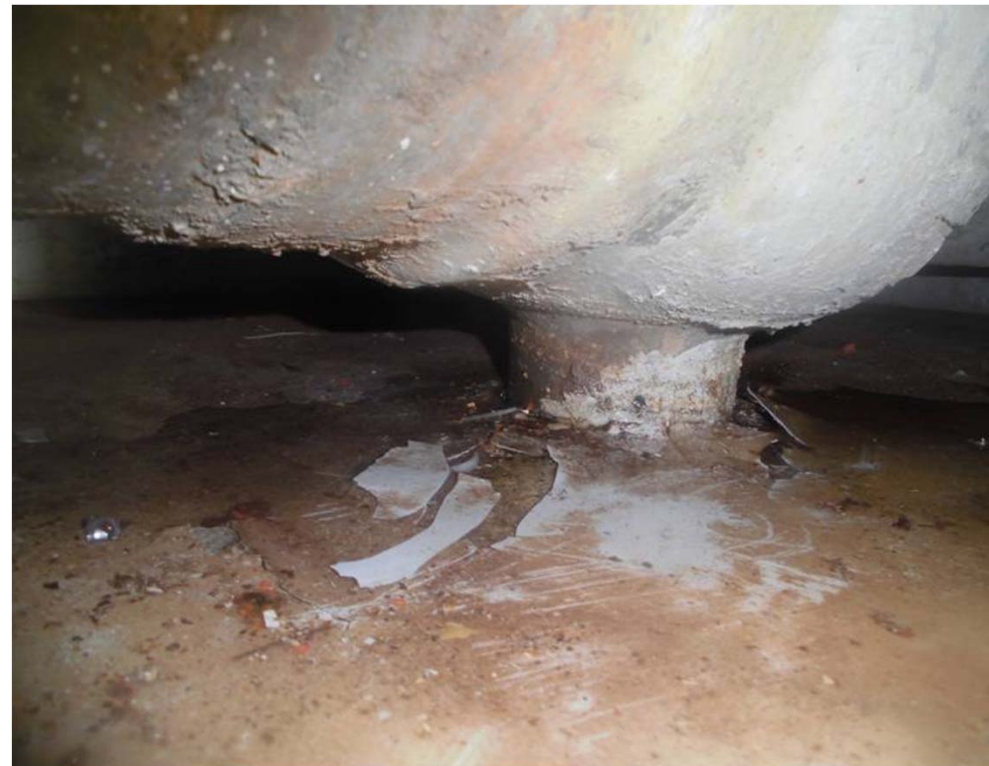
当該弁 ( F042B)下部の状況
