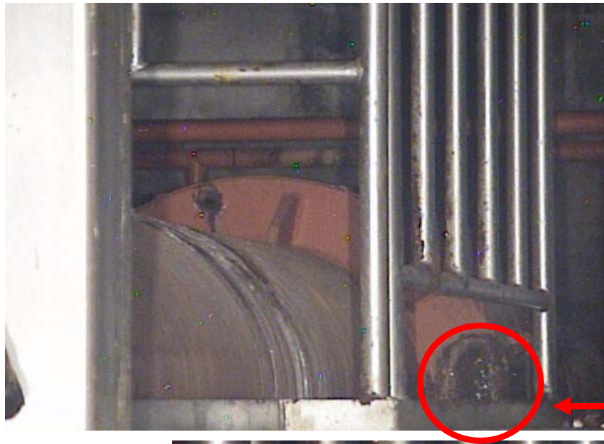
伸縮継手（反PCV側）
