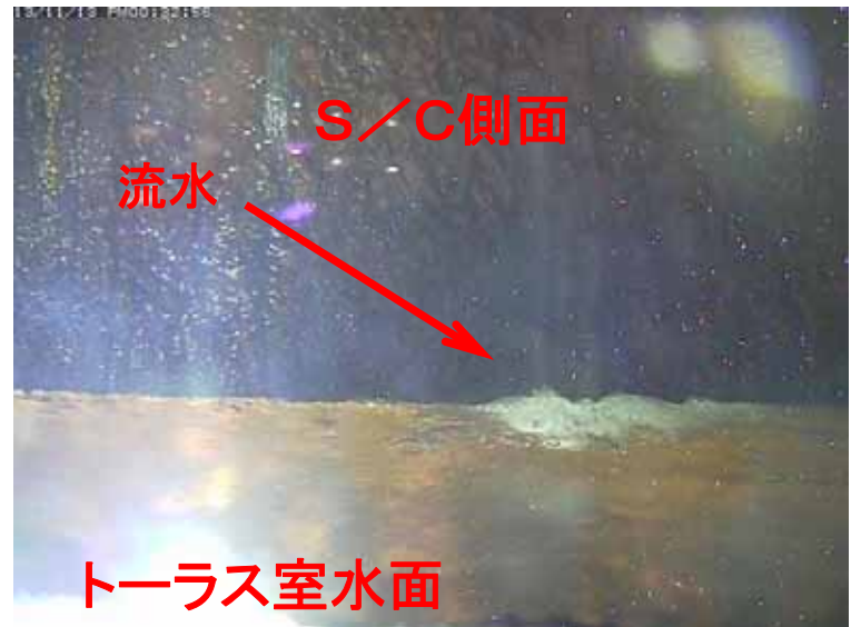
H25年11月の水上ボートによる調査で確認された流水
