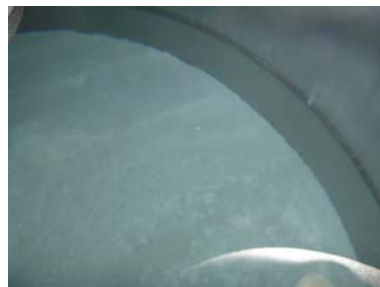
吸着塔4 A 吸着材2が白色であり、白 い堆積物の目視確認は困難
