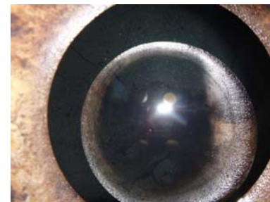
吸着塔8 A 吸着材3（黒色）の上に若 干の白い堆積物を確認
