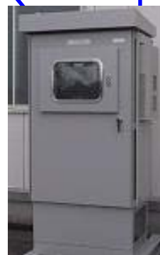
水位データ集約伝送盤
