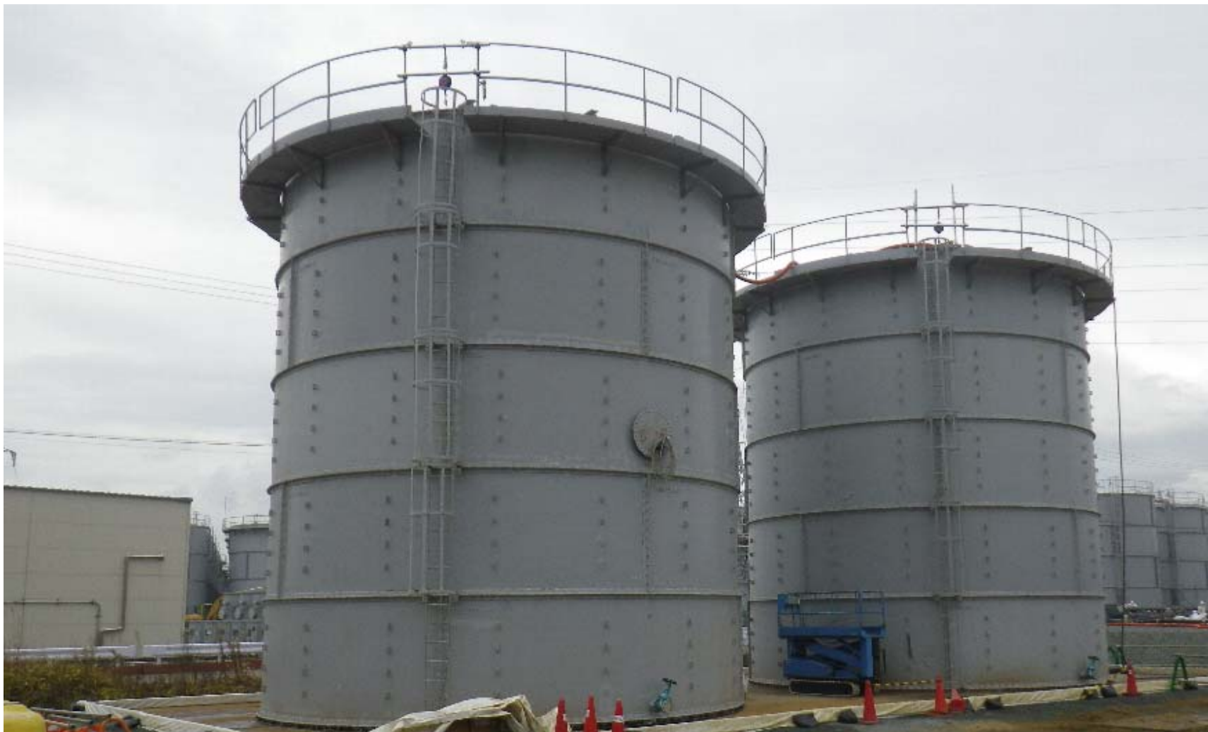
新たに設置したタンク
