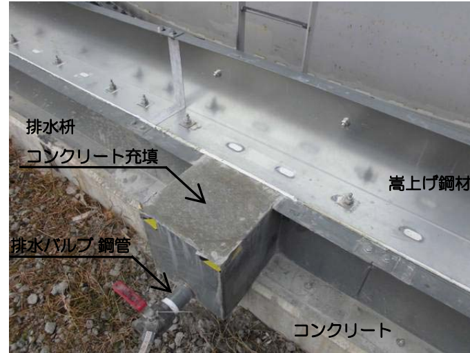
排水枡 閉塞後（外側）
