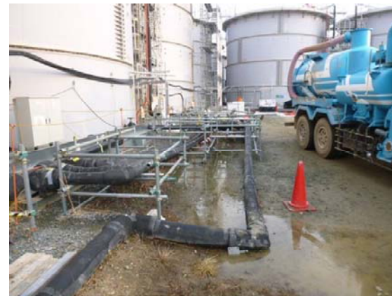
漏えいの状況 (①エリア)
