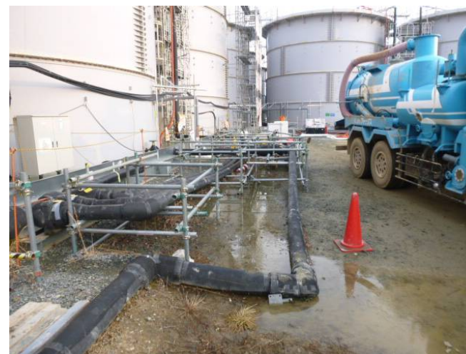
漏えいの状況（①エリア）
