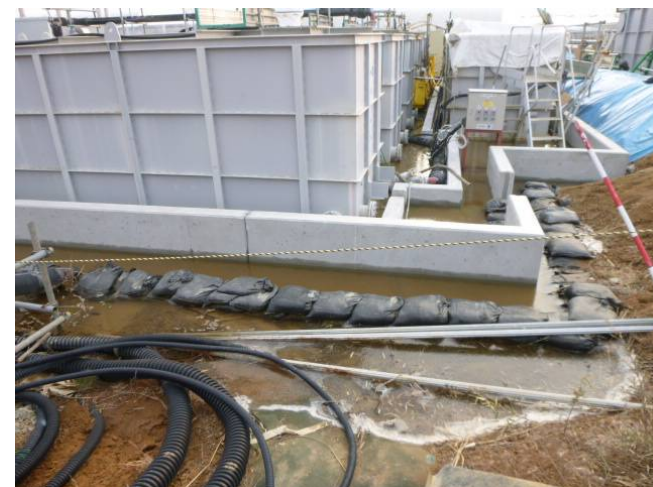
漏えいの状況（③エリア）
