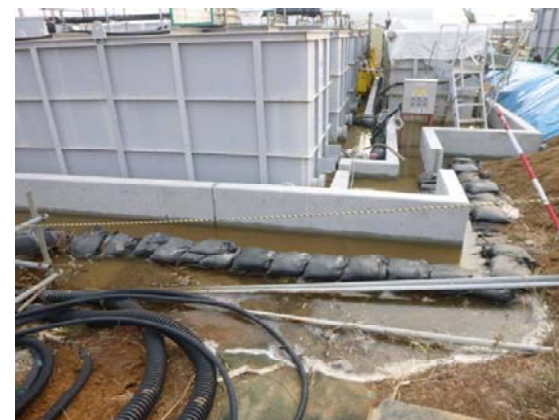
漏えいの状況 (③エリア)
