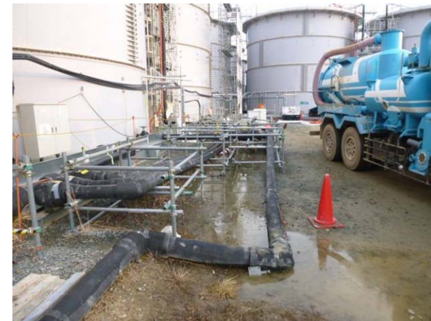
漏えいの状況（①エリア）
