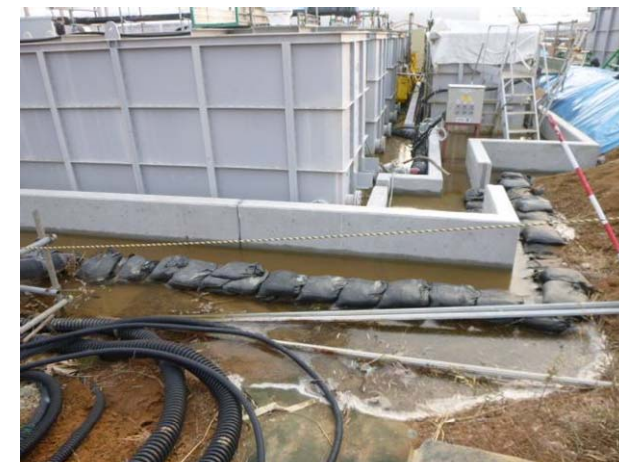
漏えいの状況（③エリア）
