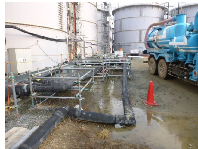
漏えいの状況（①エリア）
