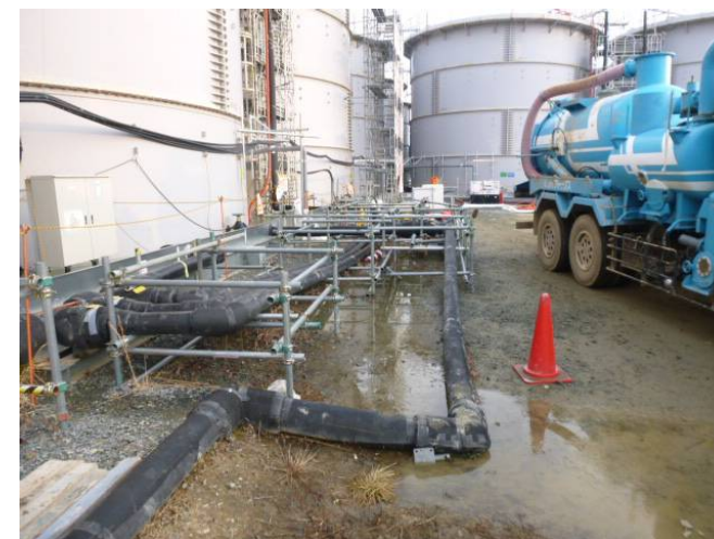
漏えいの状況 (①エリア)
