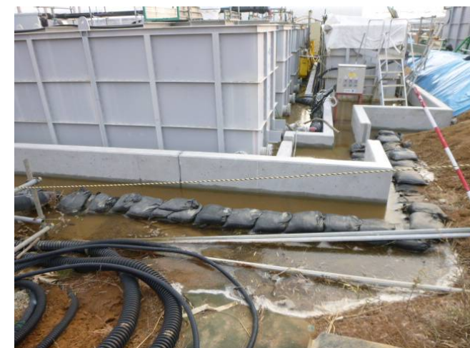
漏えいの状況 (③エリア)
