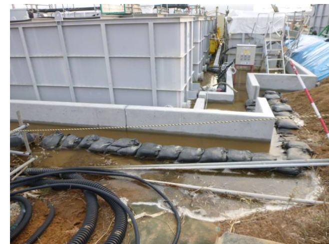
漏えいの状況（③エリア）
