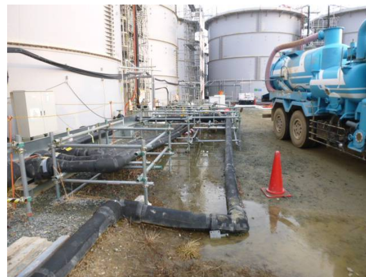
漏えいの状況（③エリア）
