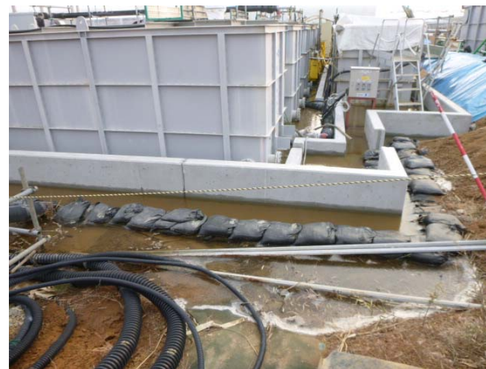
漏えいの状況（①エリア）
