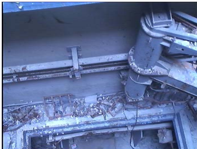
④ 2F西側外壁及び床上状況
