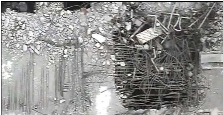
写真①床スラブの損傷
