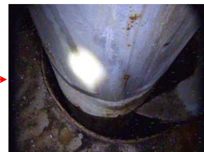
床貫通部 (事故当初、トラス室からの蒸気噴出が確認された箇所)
