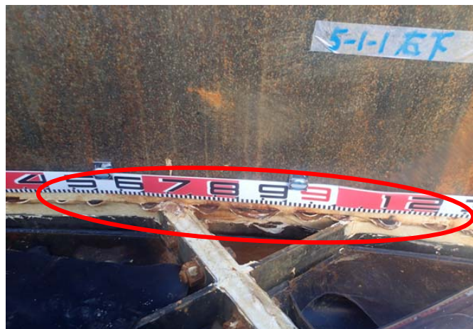
周方向フランジ部 パッキンの飛び出し
