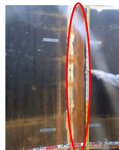
側板1段目 錆の箇所
