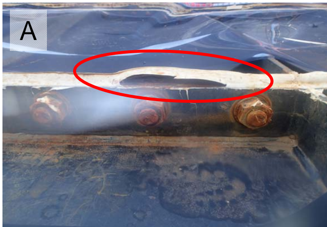
底板フランジ部シーリング材の膨らみ
