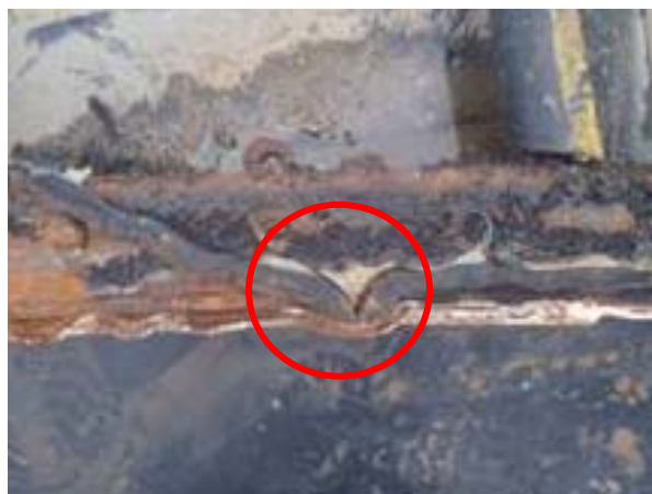
止水材の飛び出し
