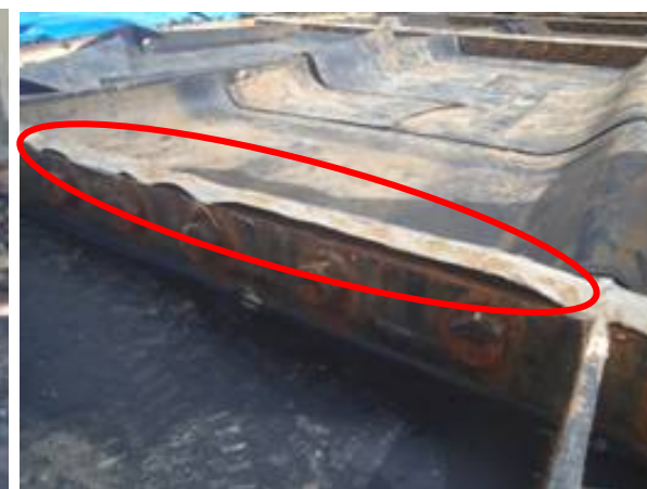
シーリング材の膨らみ
