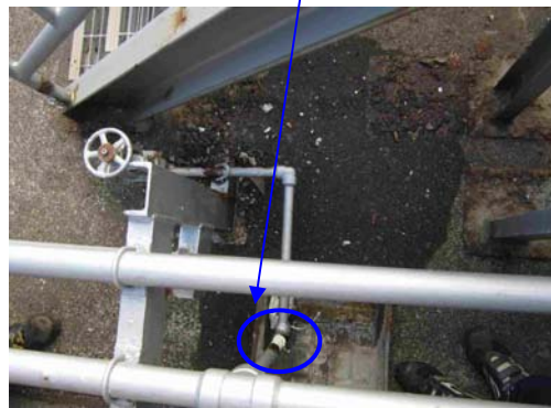
油漏れ箇所(応急処置後)
