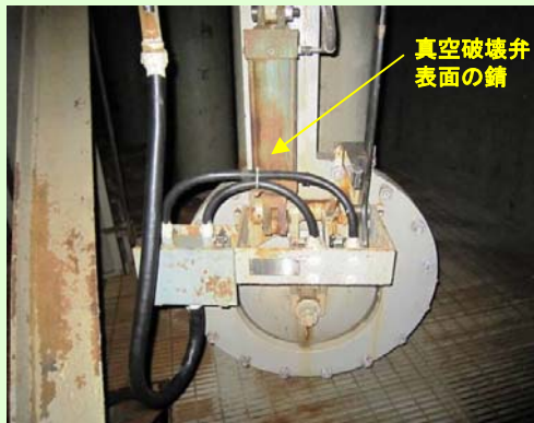
⑨真空破壊弁表面の錆 (平成24年4月17日撮影)
