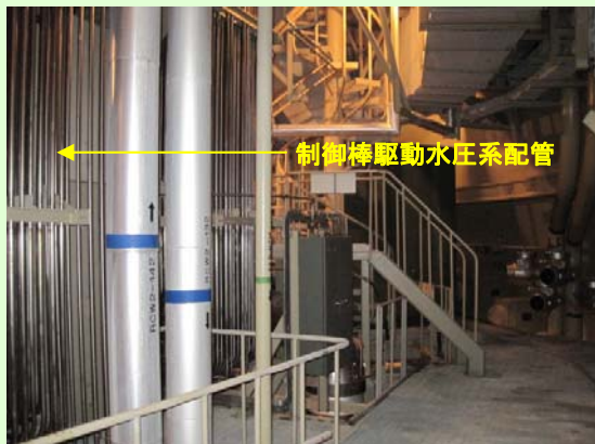
③原子炉格納容器内その1 (制御棒駆動水圧系配管周辺) (平成24年4月11日撮影)
