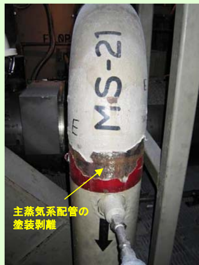
⑩主蒸気系配管の塗装剥離 (平成24年3月13日撮影)
