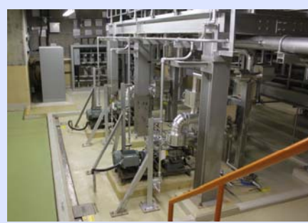
3号機タービン建屋地下2階加熱蒸気凝縮水移送 ポンプの現況(平成24年5月24日撮影)
