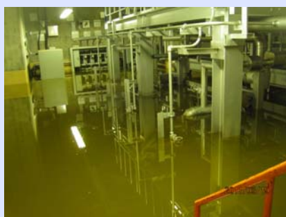
3号機タービン建屋地下2階加熱蒸気凝縮水移送 ポンプ浸水後の状況(平成23年3月19日撮影)
