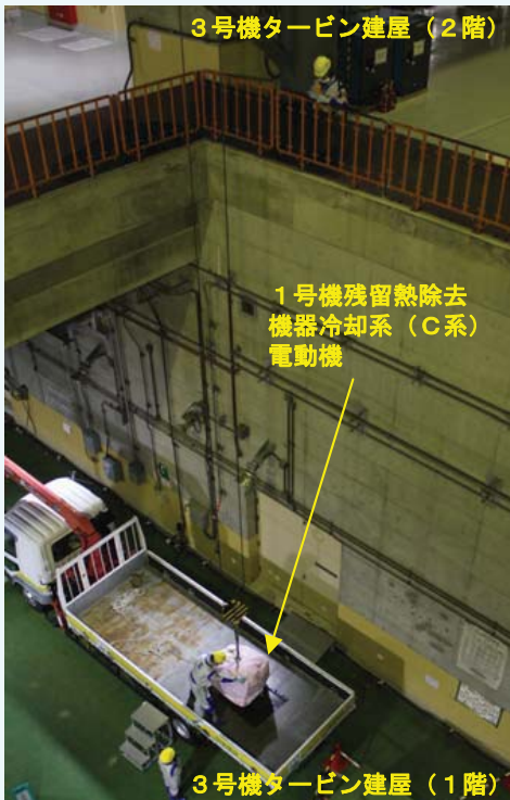
残留熱除去機器冷却系 (C系) 電動機の移動作業 (3号機タービン建屋) (平成24年5月22日撮影)
