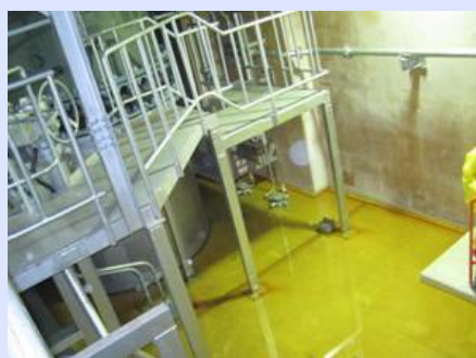
1号機タービン建屋地下1階復水器室 浸水後の状況(平成23年3月20日撮影)
