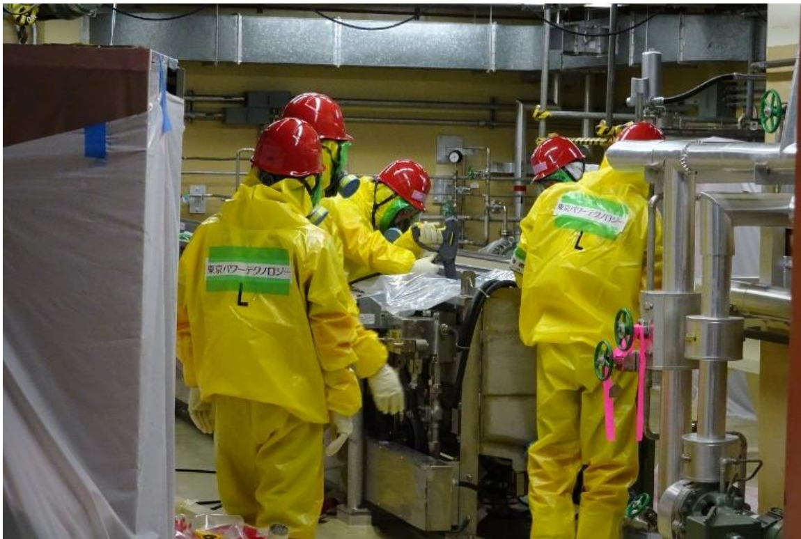
CRD半自動分解装置（1号炉）の除染作業を実施している様子
