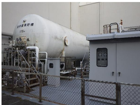
窒素供給設備（格納容器内ガス濃度制御系）
