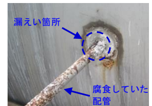
補修前の状況
