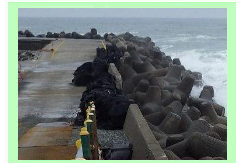
被害を受けた福島第一の防波堤
