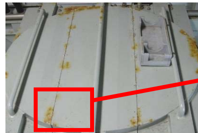
是正措置前（放水口モニタの検出槽）
