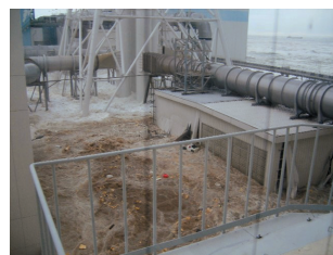
敷地内に津波が浸水
