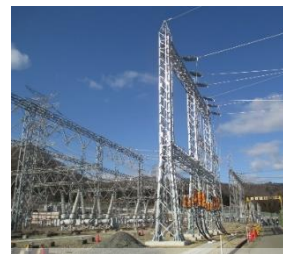
新福島変電所
