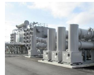
福島送電 都路変電所
