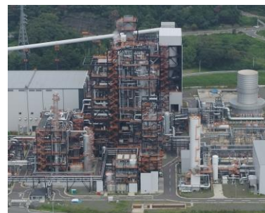
勿来IGCC発電所外観
