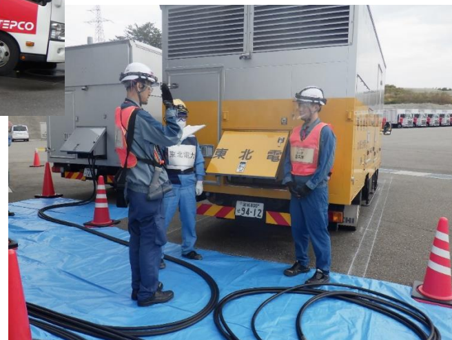
<並列運転を行う電源車>
