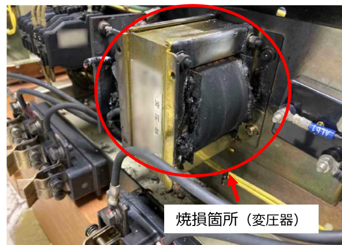
<取り出した制御機器>
