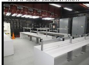
原子炉建屋内緊急時対策所
