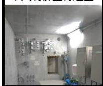
中央制御室待避室
