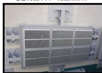
電巻防護ネット (複数箇所)
