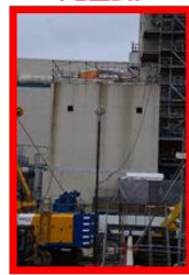
フィルタバント設備 (地上式)
