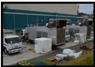
ガスタービン発電機
