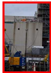
フィルタベント設備 (地上式)
