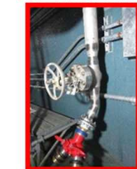
使用済燃料プールに注水するための外部接続口
