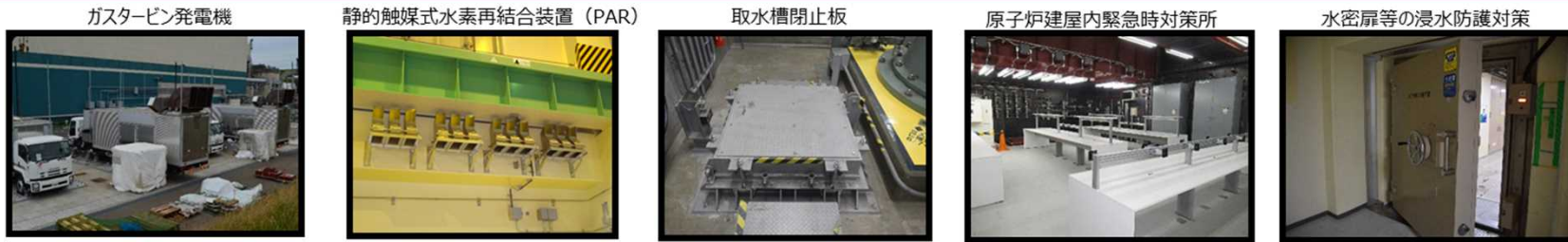
万が一の全交流電源喪失時にも重要機器の動力を確保
