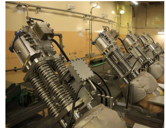
確認する弁の例 主蒸気隔離弁
