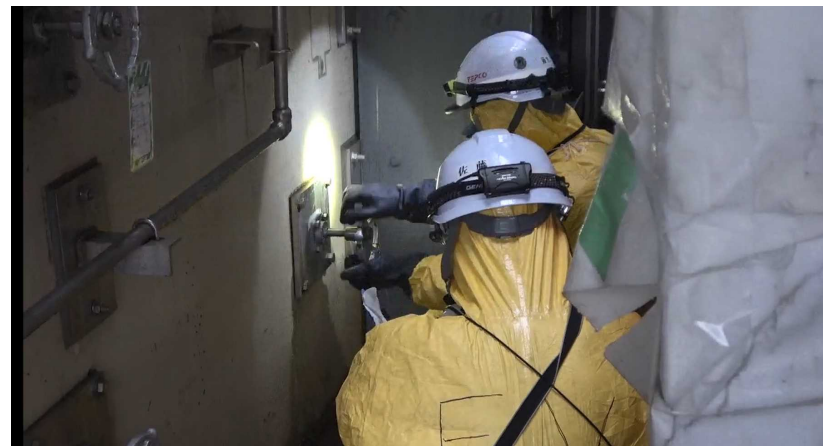
格納容器ベント操作
