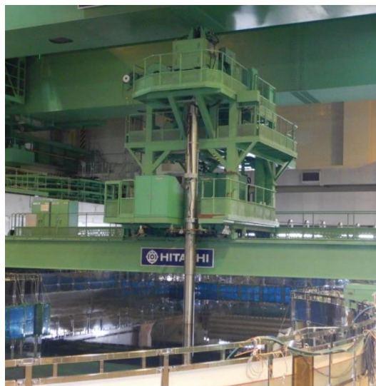
燃料取替機全体
