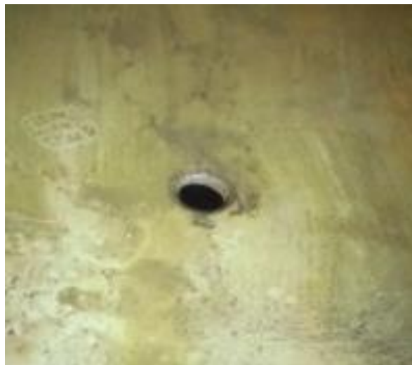
配管内側（欠損有）
