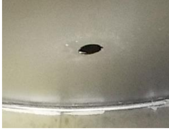
配管外側（欠損有）
