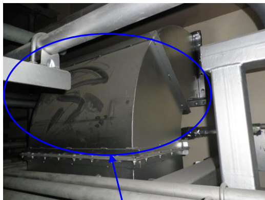
a. 7号機原子炉建屋 空調ダクト
