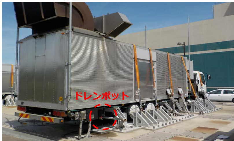
〔ガスタービン発電機車〕
