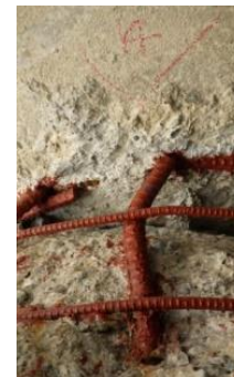
No.8杭主筋の変形状況
