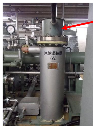
計装用圧縮空気系除湿装置（IAドライヤ）電気ヒータ
