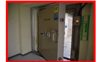
水密扉等の溢水対策 (屋内複数箇所)
