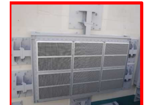
電巻防護ネット (複数箇所)
