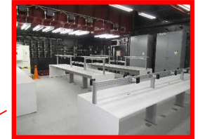
5号機原子炉建屋内緊急時対策所
