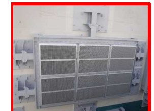
電巻防護ネット (複数箇所)
