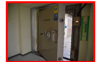
水密扉等の溢水対策 (屋内複数箇所)
