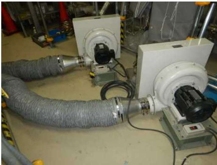
可搬型陽圧化空調機 (ファン)
