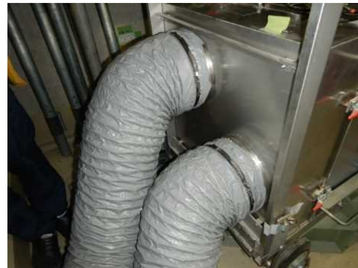
可搬型陽圧化空調機 (フィルタユニット)
