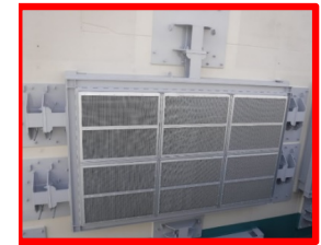
電巻防護ネット (複数箇所)
