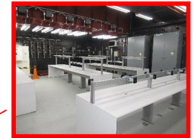
5号機原子炉建屋内緊急時対策所
