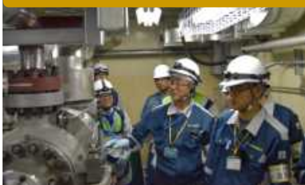
高圧代替注水ポンプ
