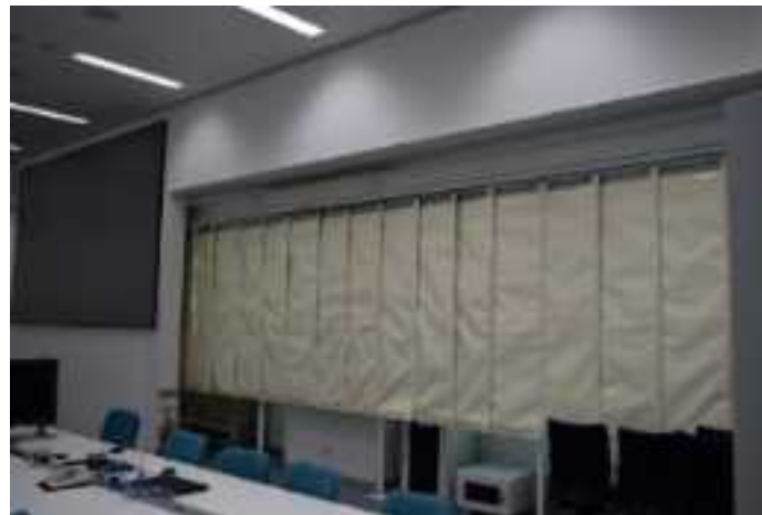
緊急時対策本部に設置した鉛板の遮へい材
