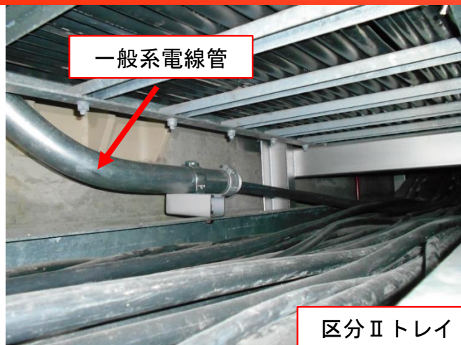
3号機 ケーブル敷設の不適合パターン例 (現場ケーブルトレイ)
