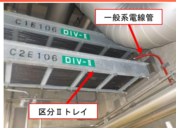
7号機 ケーブル敷設の不適合パターン例 (現場ケーブルトレイ)
