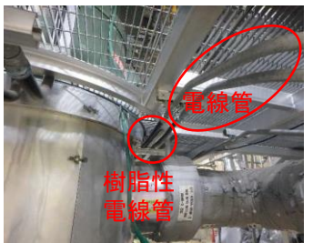
樹脂性電線管 電線管 残留熱除去系ポンプ
