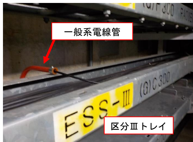
2号機 ケーブル敷設の不適合パターン例 (現場ケーブルトレイ)
