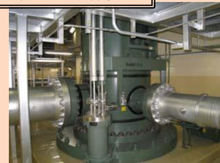
残留熱除去系ポンプ
