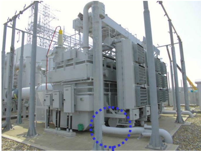
<高起動変圧器>
