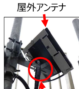
屋外アンテナ コネクタ接続部
