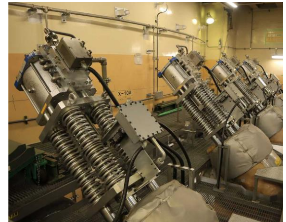
確認する弁の例 主蒸気隔離弁
