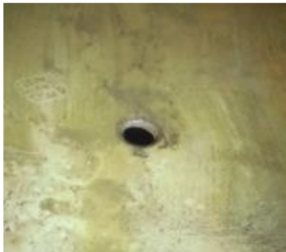
配管内側（欠損有）
