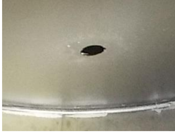
配管外側（欠損有）
