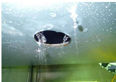
<★欠損箇所（配管外部より撮影：10/20）>
