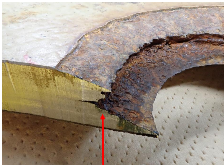
<欠損箇所（破断面）>
