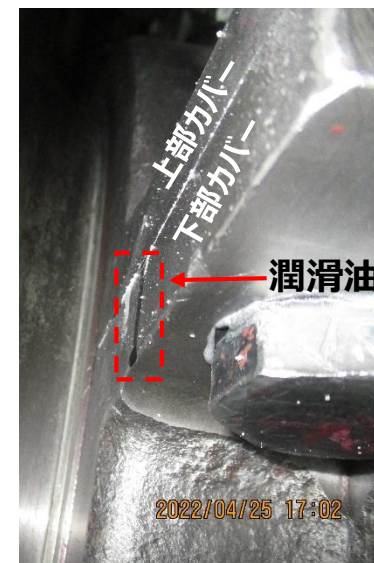
4/25 油漏れ確認時
