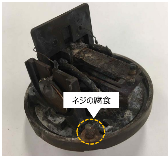
当該自動点滅器センサー部 内部
